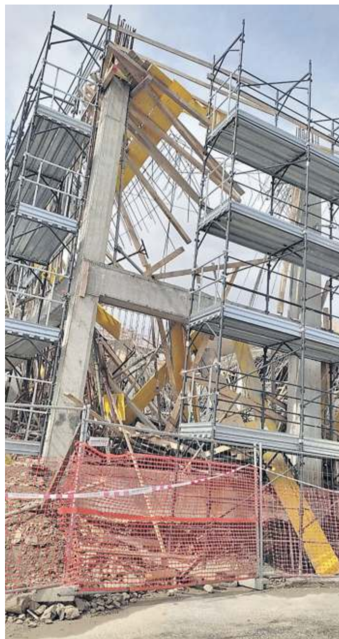
Il crollo del solaio della palestra
